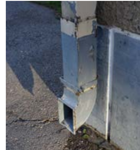
Kuva: Alkuperäinen paikalla maalattu syöksytorvi, as.oy Sammonkatu 21-23
